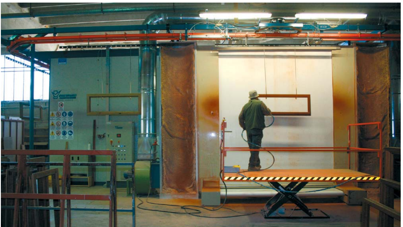
8 – Una vista generale del nuovo impianto di verniciatura, zona d'applicazione delle finiture. 8 - View of the new coating line, the zone for applying the finishes.
