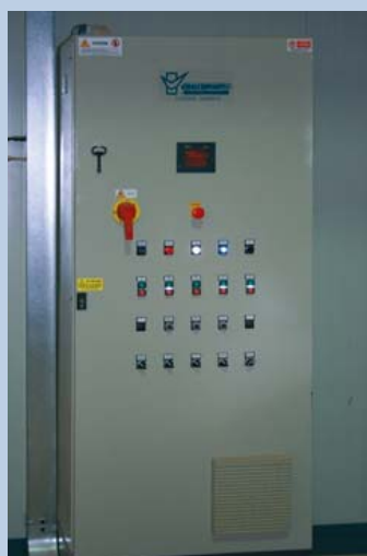
2 – Il quadro generale di controllo e comando della linea di verniciatura.
